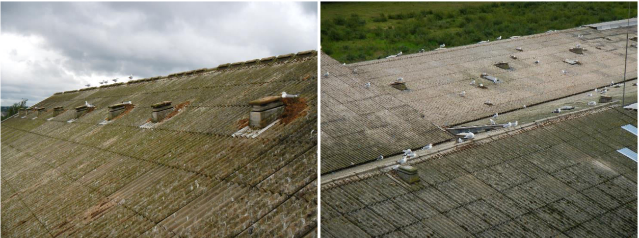
Figure 1 : Nids de Goéland argenté sur toit en fibrociment – Photos TBM environnement
