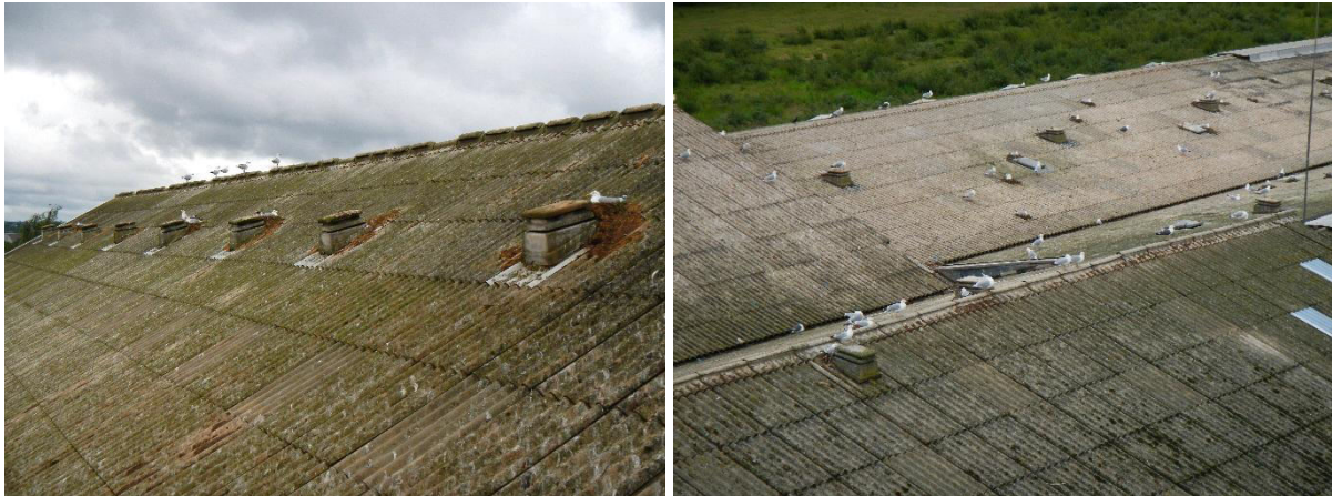
Figure 6 : Nids de Goéland argenté sur toit en fibrociment – Photos TBM environnement
