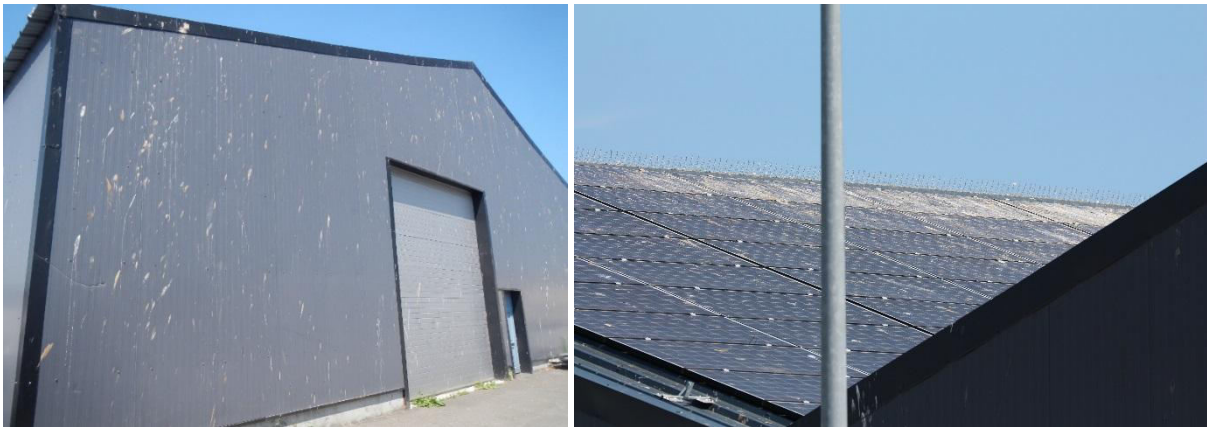
Figure 10 : Fientes de goélands sur bâtiments et panneaux solaires – Photos TBM environnement
